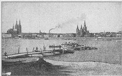
155. Pioniere beim Bau einer Funtenbrücke (Bau der Pontonbrücke). Nach einer Photographie von Karl Scholz, Köln-Deutsch.
